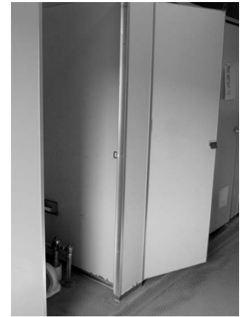
ドアの壊れたままだった 中学校の女子トイレ すぐ直りました 〔04年〕
